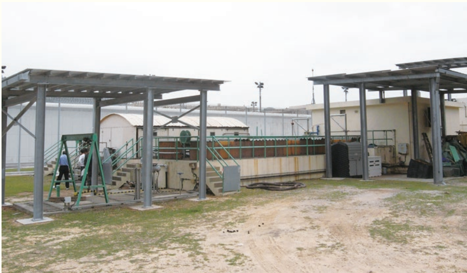
石壁生物轉盤污水處理廠
