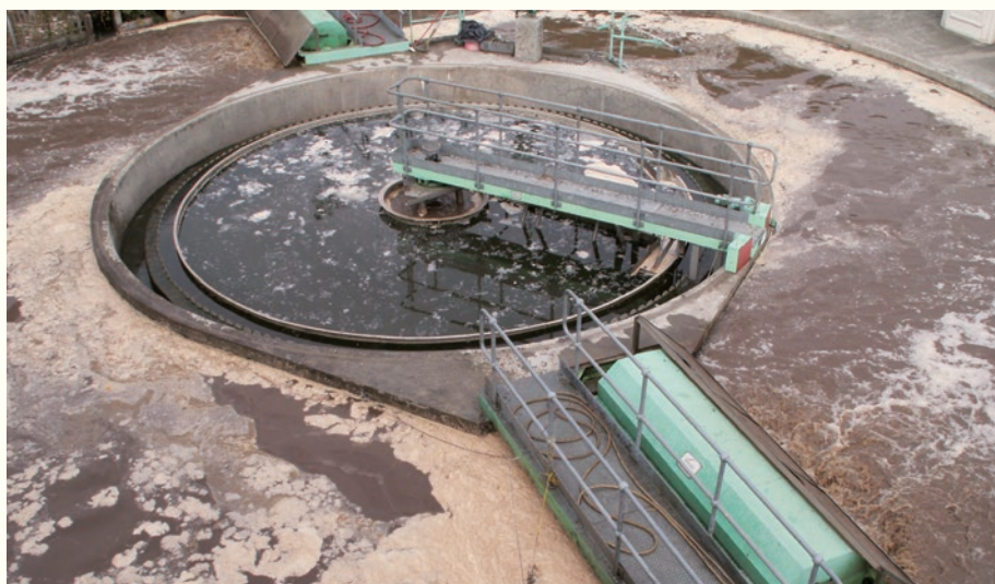
喜靈洲氧化溝污水處理廠
