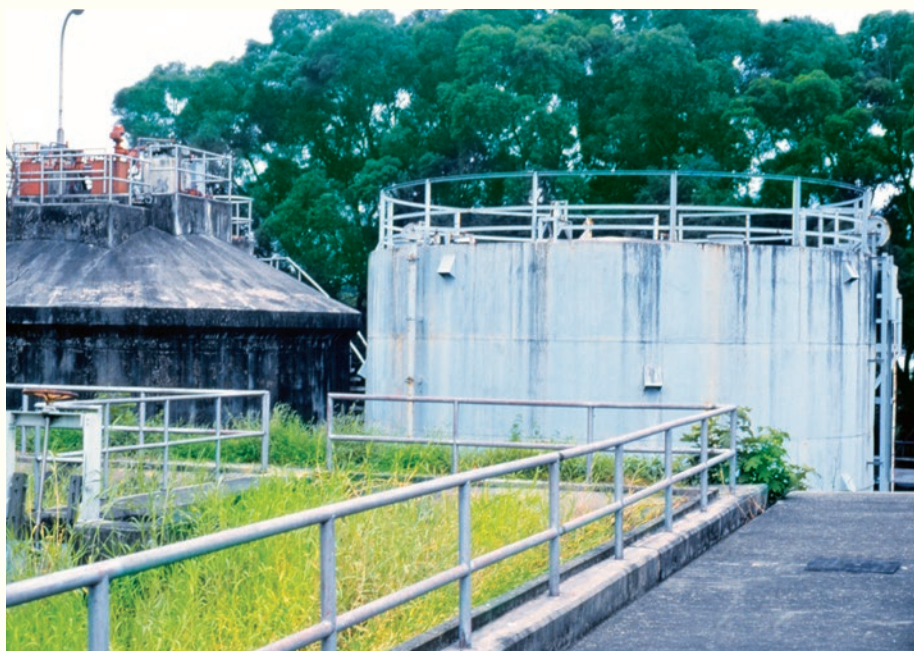
石湖墟試驗性二級污水處理廠的厭氧污泥消化缸
