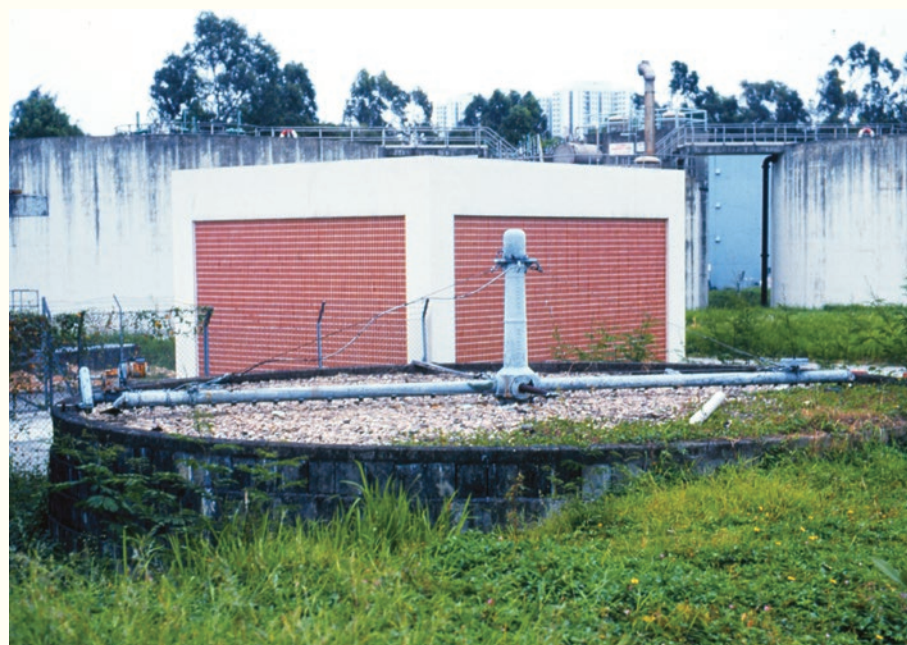
石湖墟試驗性污水處理廠的滴濾池
