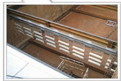
安裝於沉澱池內的多孔擋板 Perforated energy-dissipating baffles
