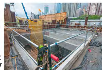
辟味室 Deodorization Chamber
