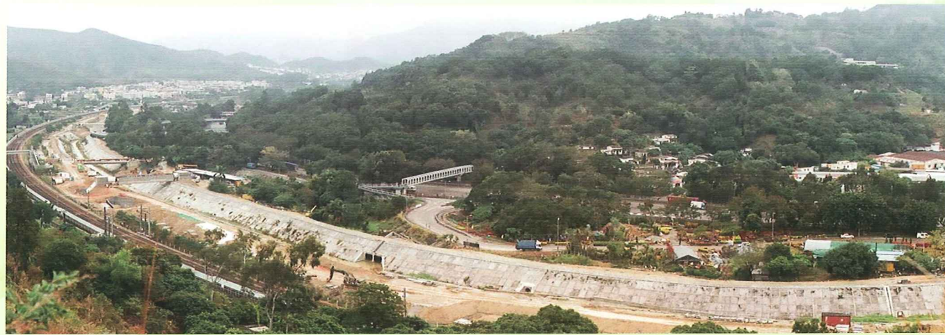
麻笏河排水道建造工程第一期地盤鳥瞰圖 Aerial view of the construction site of Ma Wat River Channel Phase 1
