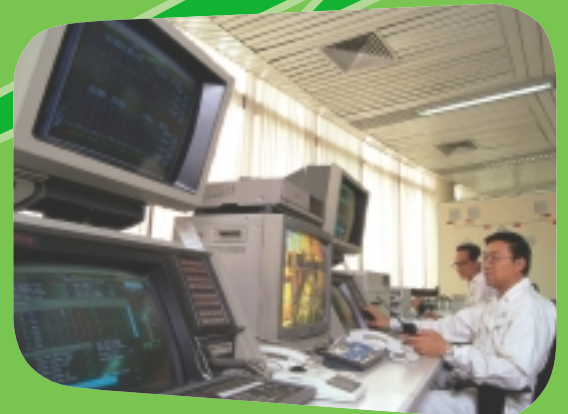
電腦化控制中心 Computerized control centre
