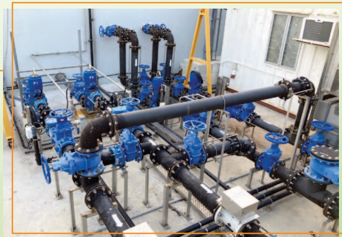
以預先裝嵌組件再移至工地接駁方式完成的污水泵及相關設備
