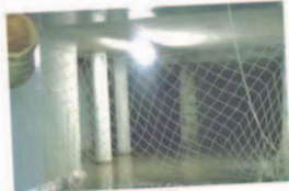
設於箱型暗渠內的救生網
