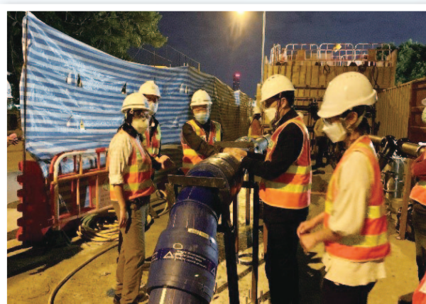
3 月 11 日晚上，署長（左一）親臨見證污水泵房順利運作
