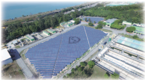
小蠔灣污水處理廠太陽能發電場
