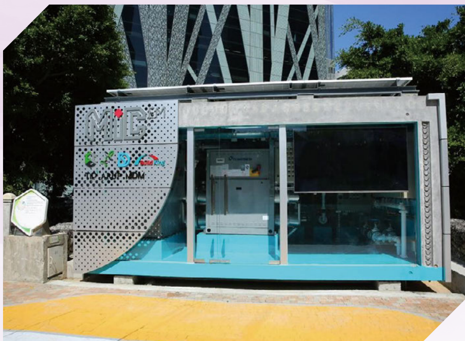
全港首個機電組裝合成雨水空調系統
