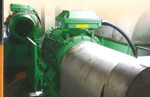
離心式污泥脫水機 Sludge Dewatering Centrifuge
