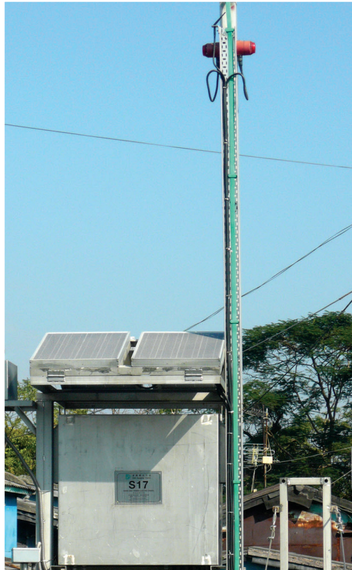
洪水警告響號系統的警報器
