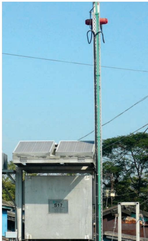
洪水警告響號系統的警報器
