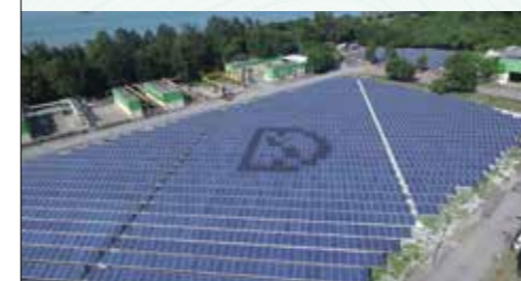
小蠔灣污水處理廠的太陽能發電場 Solar Farm at Siu Ho Wan Sewage Treatment Works
