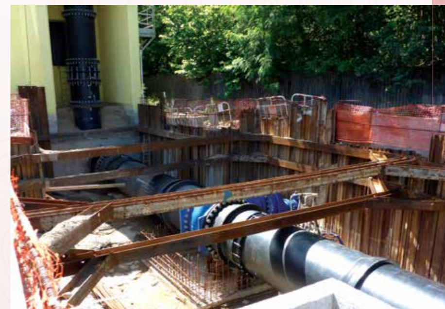
新建的加壓污水管 The new sewage rising main
